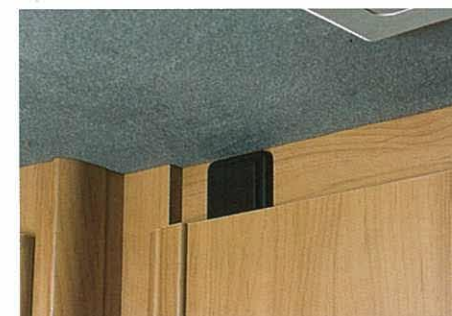
In allen Missouri-Modellen ist im Türbereich der Bäder eine Steckdose installiert.
